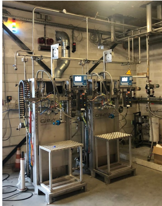
Figure 8 : Exemple d'installation de conditionnement de GLI
